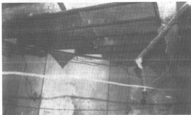
Techos en lamentable estado, sin cielos y con peligro de corto-circuito, que ya fueron restaurados.
