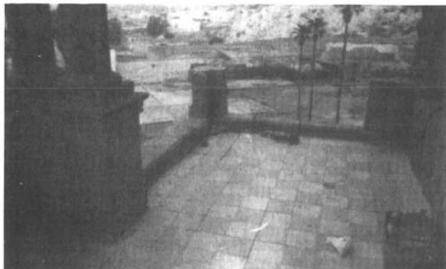
Las terrazas del primer y segundo piso sin barandales balaustrados, sin pilares...
