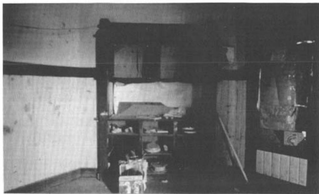
Así se encontraba el trinchador antes de la restauración.
